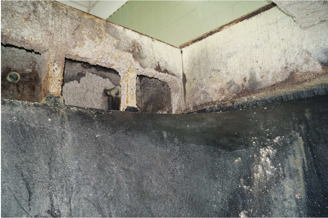
Zdj. 5) Otwory przelewowe – odsłonięte zbrojenie słupków
