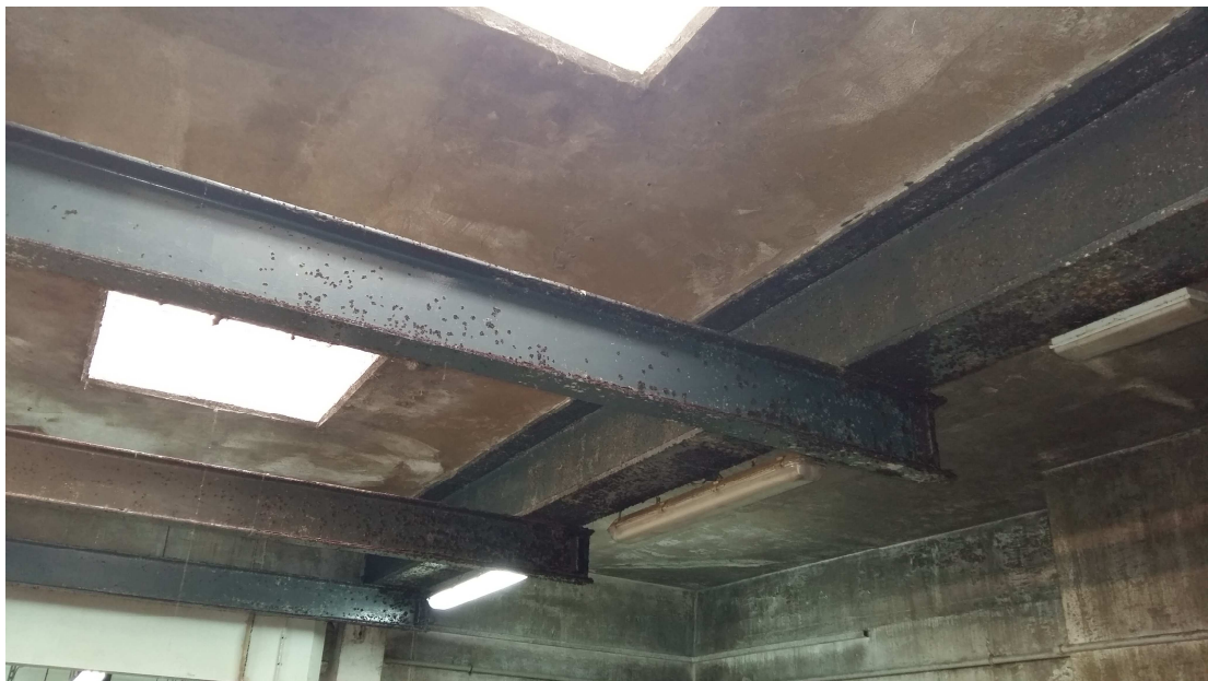
Zdj. 8) Widok na skorodowane elementy stalowe i zawilgocone ściany i sufit
