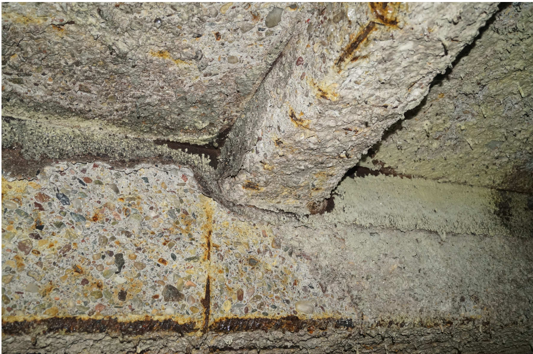
Zdj. 6) Elementy betonowe stropu łapacza piasku – odsłonięte zbrojenie, ubytki betonu
