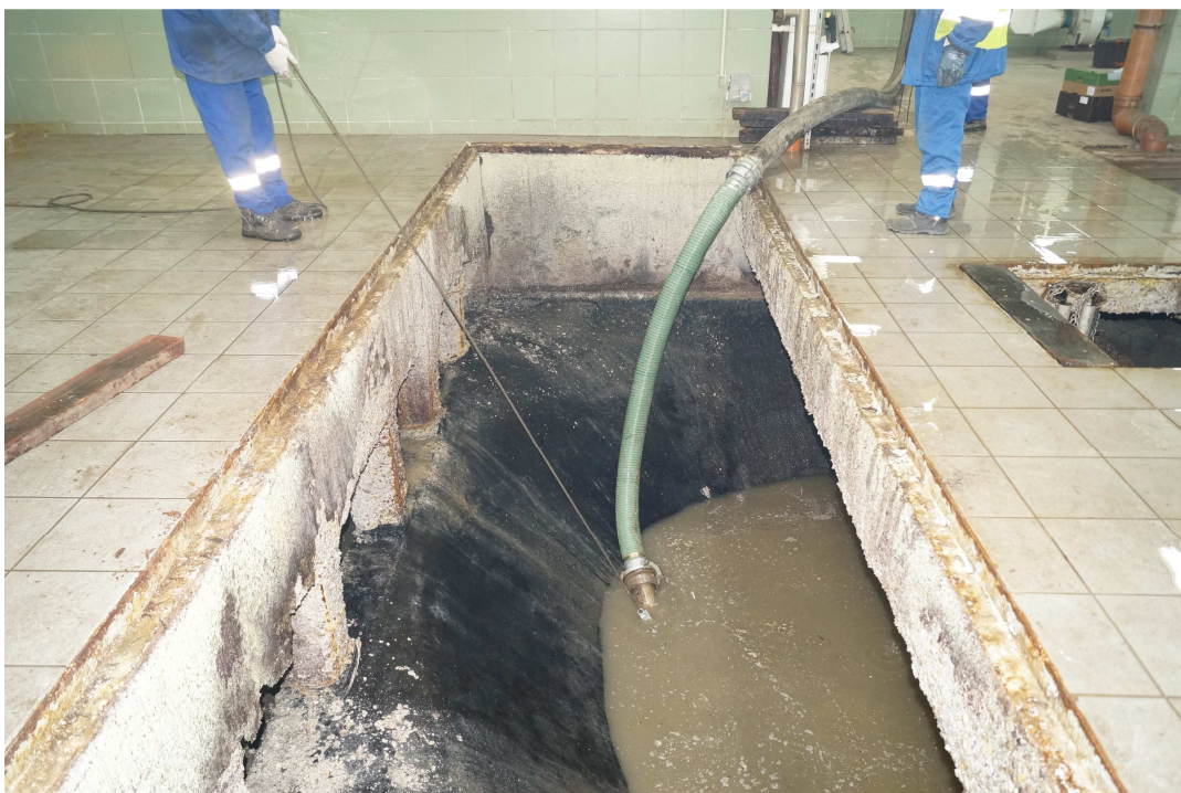
Zdj. 2) Łapacz piasku z widocznym lejem i otworami przelewowymi po prawej stronie
